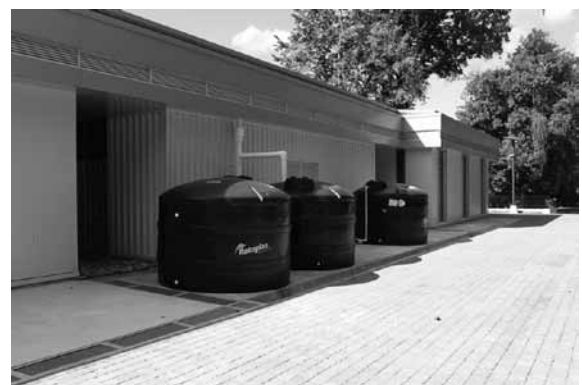
写真4 センター外部の雨水貯水タンク
